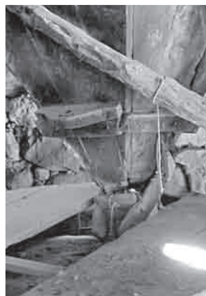
Canaleta de alimentación con válvula (Lacabazonada, 2011)
