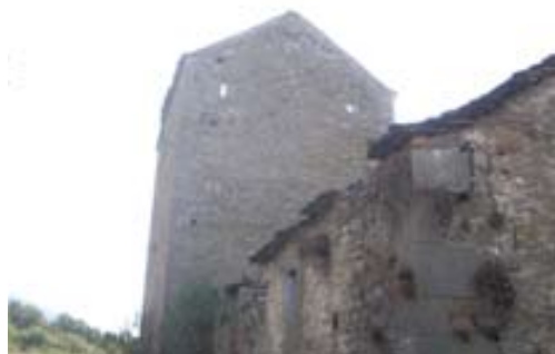
Vista general con la casa cayendo
