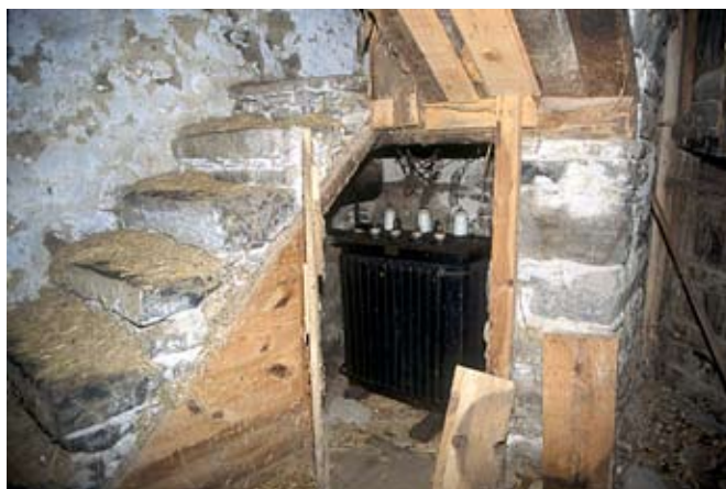
Transformador molino Sarvisé 1955
