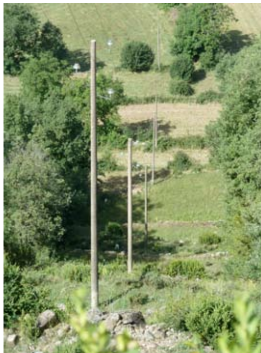
Línea suministro Buesa.
