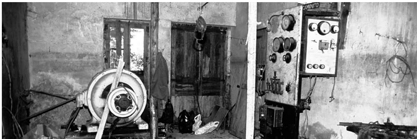
Alternador Siemens; puerta de entrada; cuadros de mando
