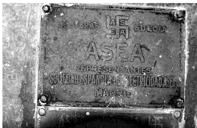
Placa de ASEA sobre el generador
