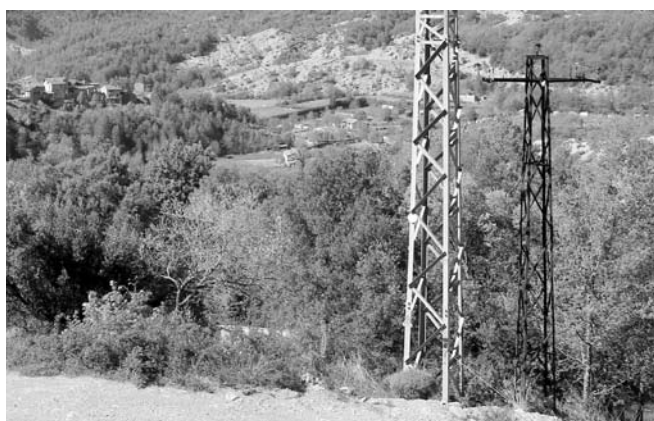
Poste nuevo y antiguo
