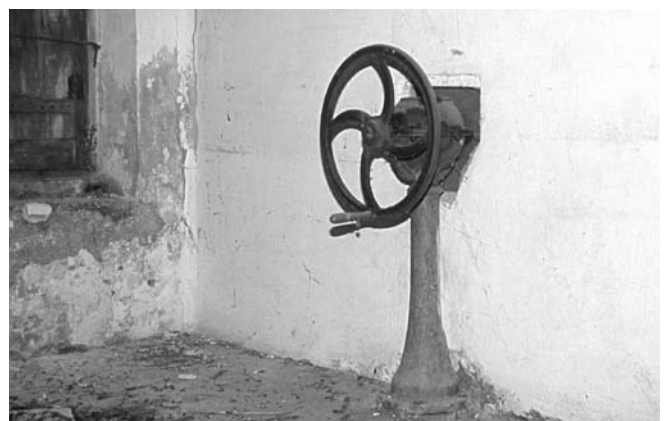
Rueda de control para la turbina Teisset Chapron
