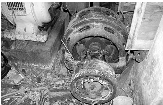
Generador de ASEA
