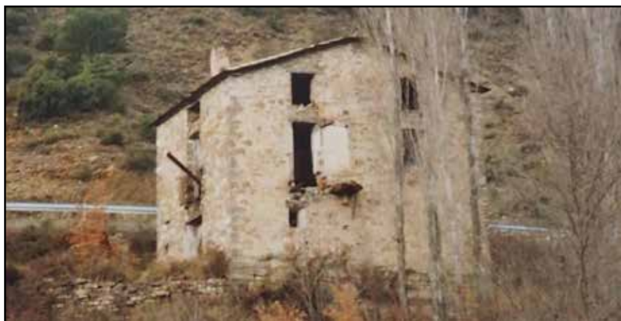
El molino de harina y central eléctrica con señales de deterioro
