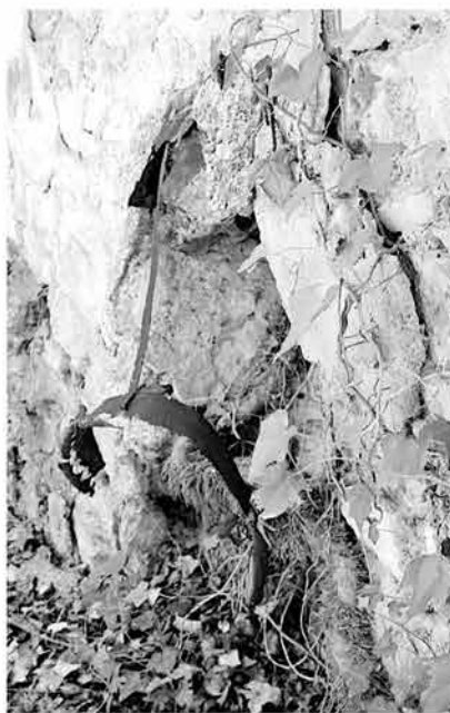
Restos de un tubo de presión
