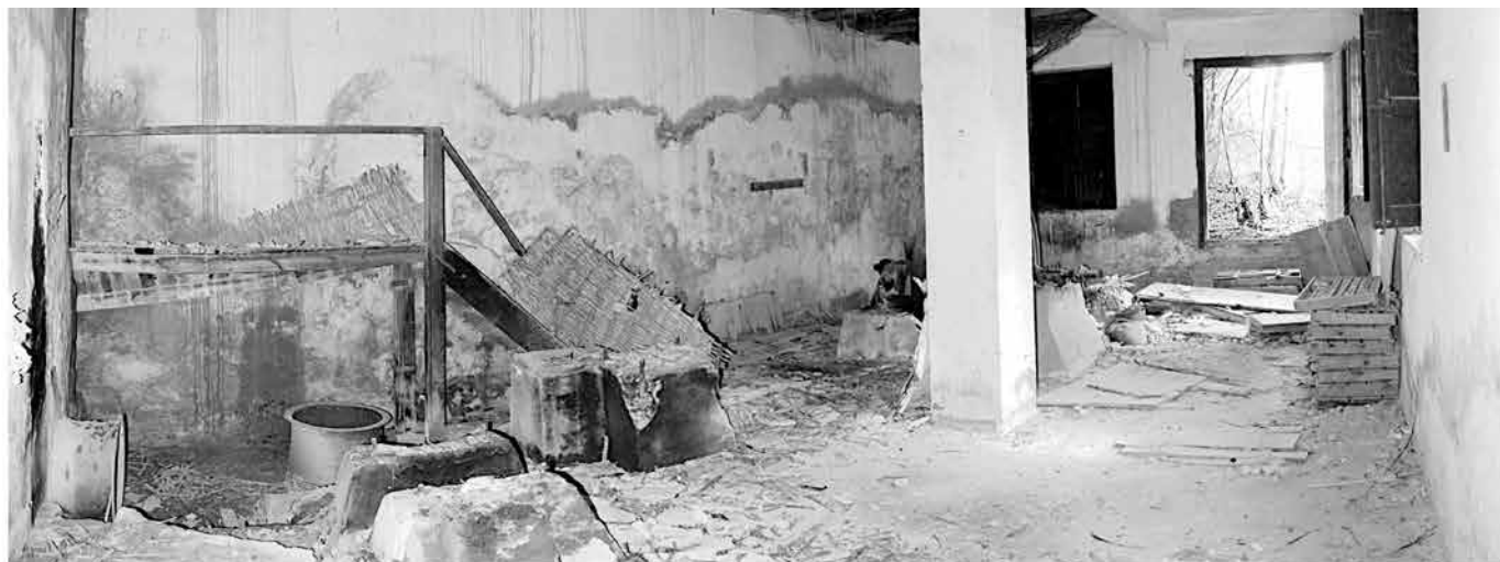
Vista general de la central eléctrica vacía
