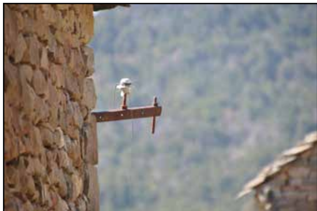
Restos de anclajes
